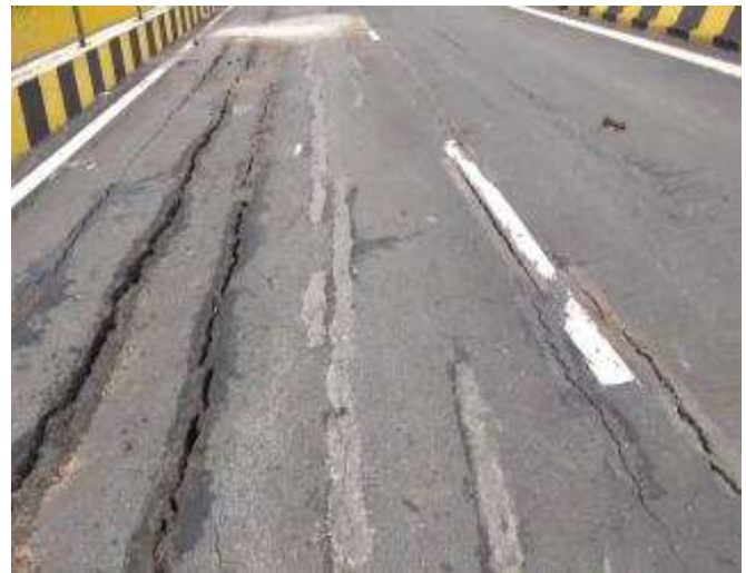
(d) High Severity longitudinal cracks
